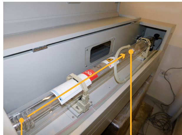
Entrada de agua
